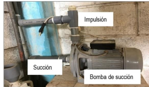
Figura 6. Bomba de impulsión.
