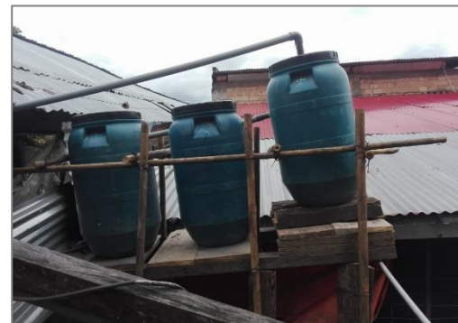
Figura 7. Tanque de sedimentación, filtro y almacenamiento.
